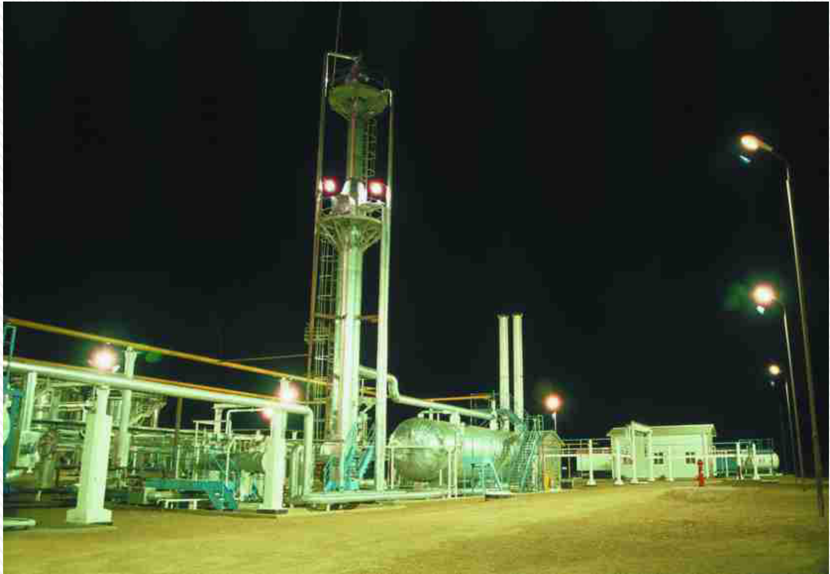
Coloana de stabilizare condensat
